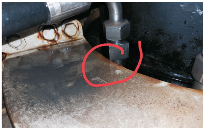
Рис. 2. Грань переходника подвода воды зацепилась и повисла на крышке уплотнения вала турбины
